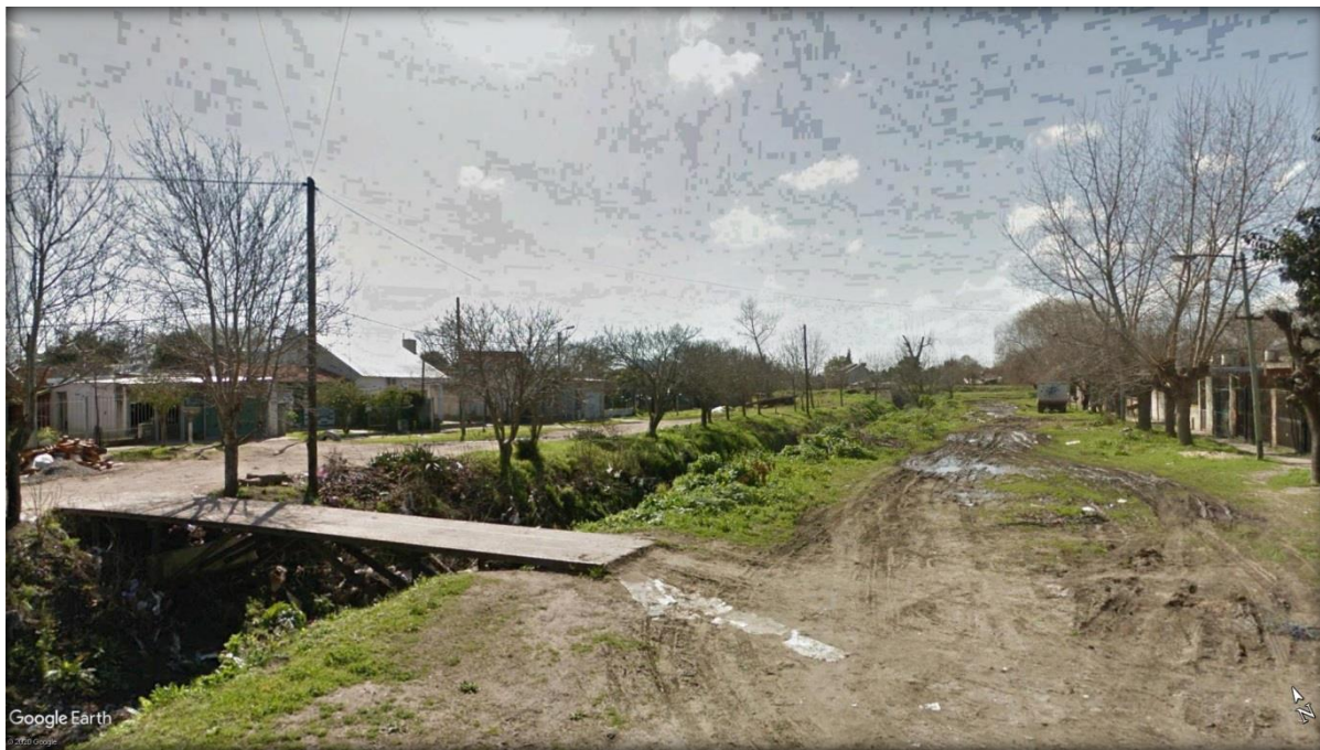
Fig. 21: Calle 210 y Tapalquén. Puente peatonal (precario)
