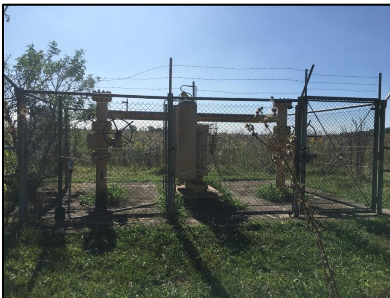
Imagen N° 2.7: Válvula de bloqueo N° 86. Coordenadas geográficas: 34°54'15,35" S y 58°12'48,63" W.
