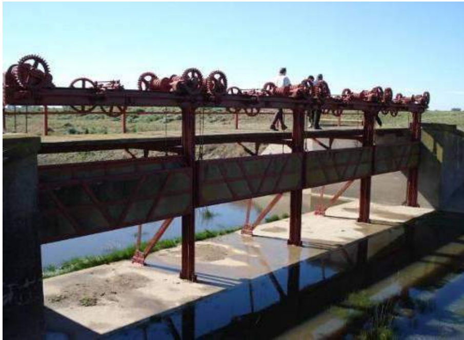
Imagen 2: Compuertas del Canal N°11.
