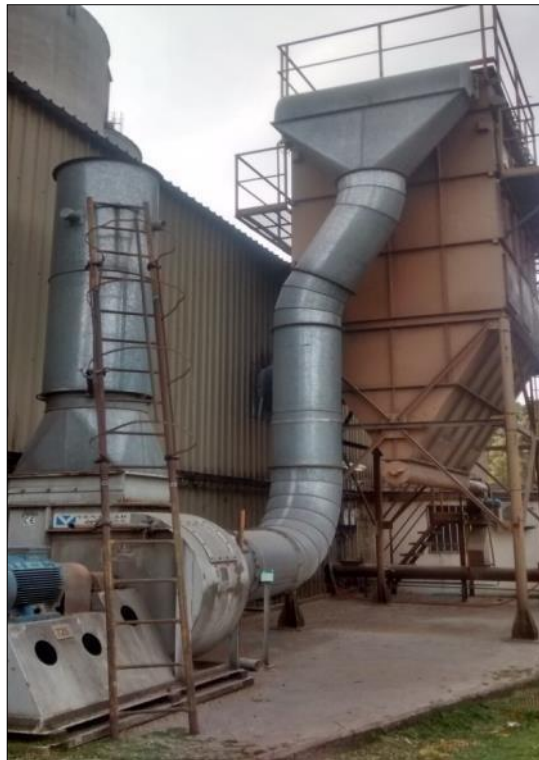
Imagen 28: Sistema de aspiración de polvo del área de vagones.
