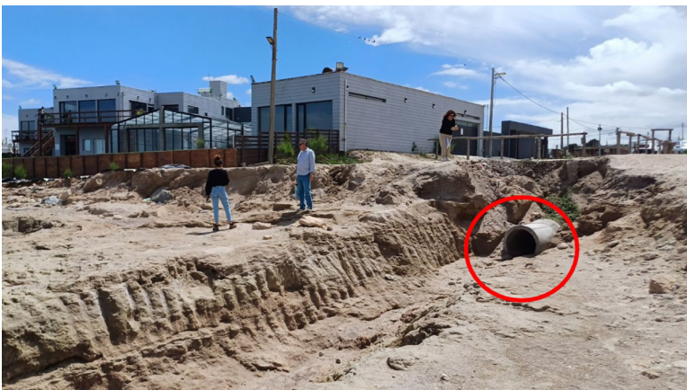
Figura 110. Descarga de pluviales hacia el acantilado. Bahía de los Vientos, punto N1. Fuente: MAPBA
