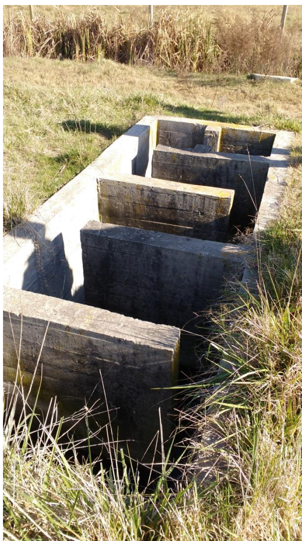
Figura 8: Cámara de cloración.
