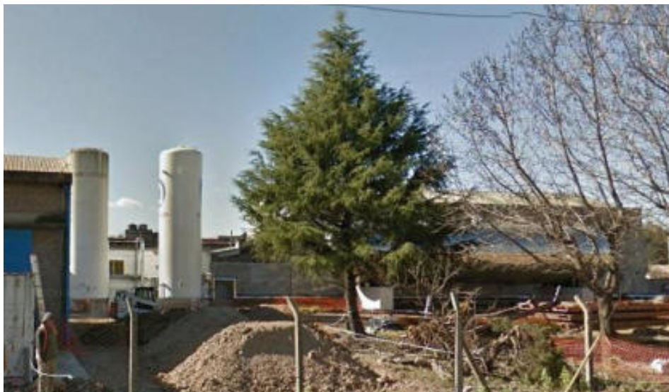
Vista desde Panamericana de Tanque Criogénico Vertical de 50 m 3 , a su lado izquierdo uno similar a desmontar y a su derecha el Tanque Horizontal de 274 m 3 próximo a habilitar
