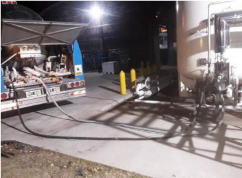
Descarga desde Camión Criogénico a Tanque de 50 m 3
