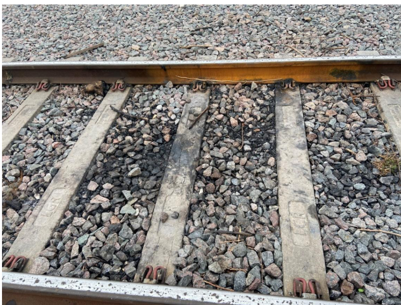
Fotografía 23 Vista norte en PR N 6. Vista sobre las vías en el cruce peatonal informal donde se observan restos de neumáticos quemados.
