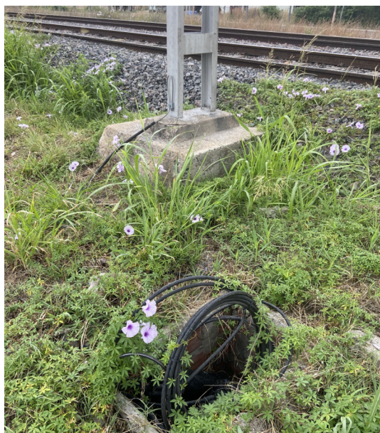
Fotografía 47 Cámara soterrada con líneas de fibra óptica
