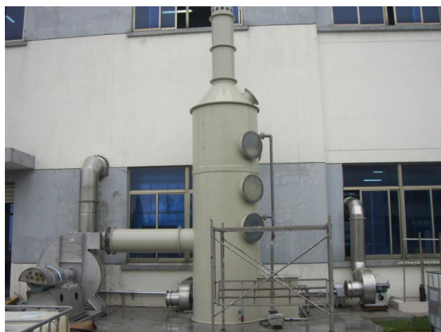
TORRE DE LAVADO
