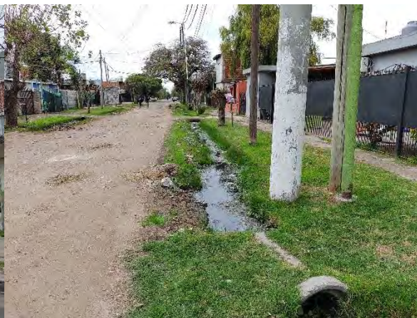
Figura 06: Alfredo Palacios esquina Martín Fierro. Zanja colmatada
