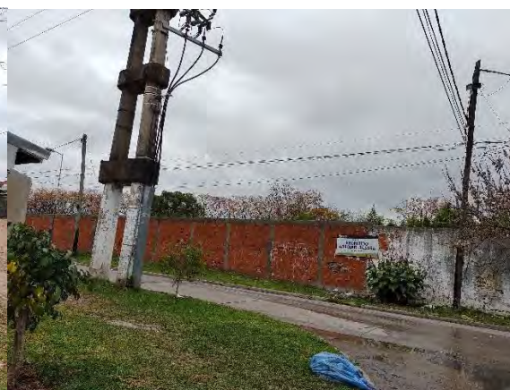
Figura 08: Alfredo Palacios esquina Obrien. Cementerio Parque Grand Bourg / Tendido eléctrico de media tensión
